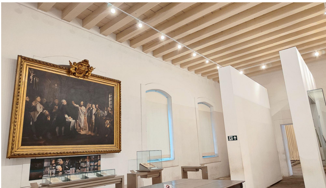
Instalações luminotécnicas executadas Autoria: Francielle Ferreira Data: 30/07/2025
